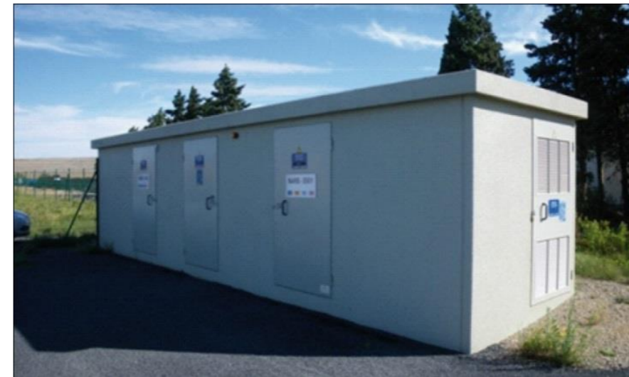
Photographie 126 : Exemple de poste de livraison "brut"
